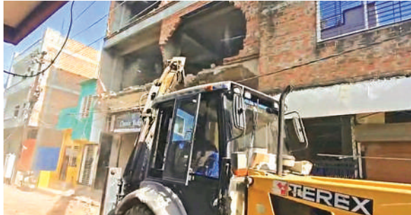
तीन मंजिला भवन के अवैध हिस्से को जेसीबी से गिराता नगर निगम का अमला।
